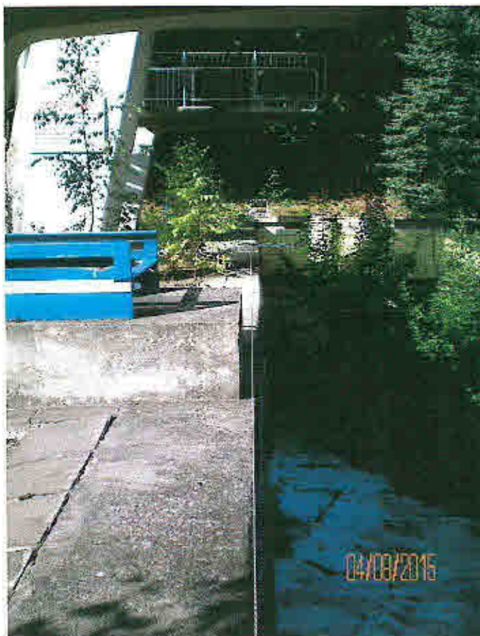
Bild 40 Beckenwand Turmseite, Verformung/Durchbiegung
