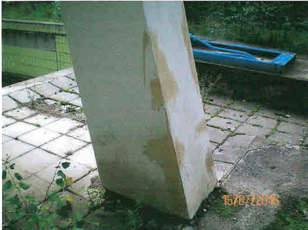
Bild 31: Stiel rechter Turm, Reparaturstellen
