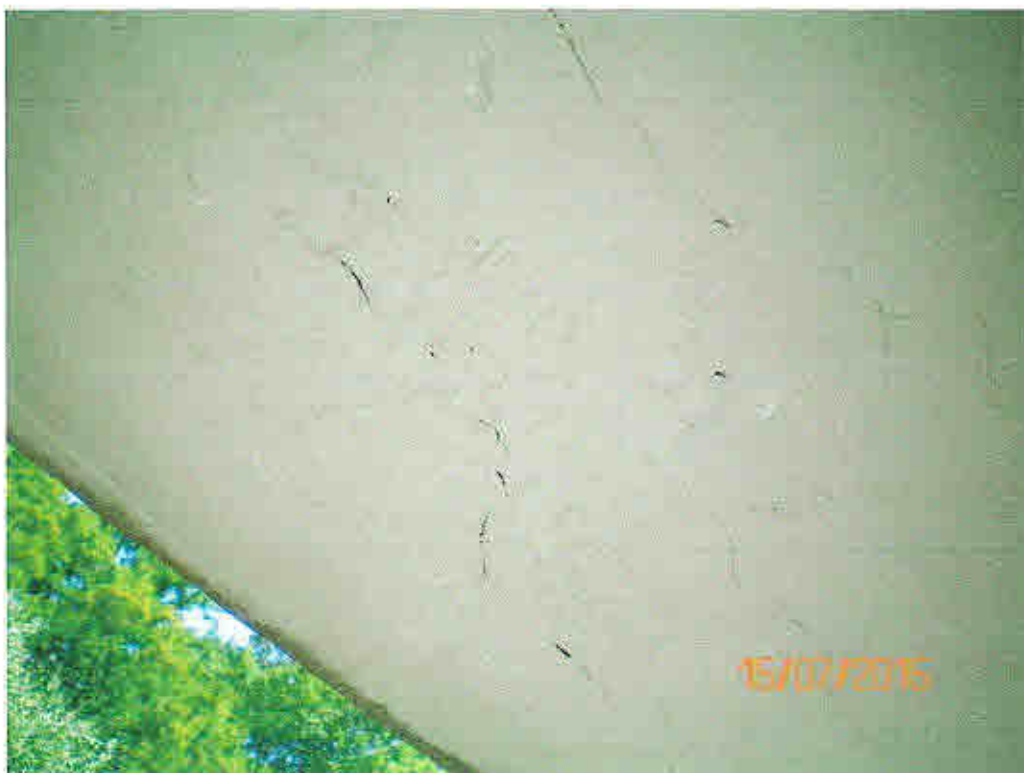
Bild 20: Rissgruppe, ungleichmäßig, Unterseite Podest UPL
