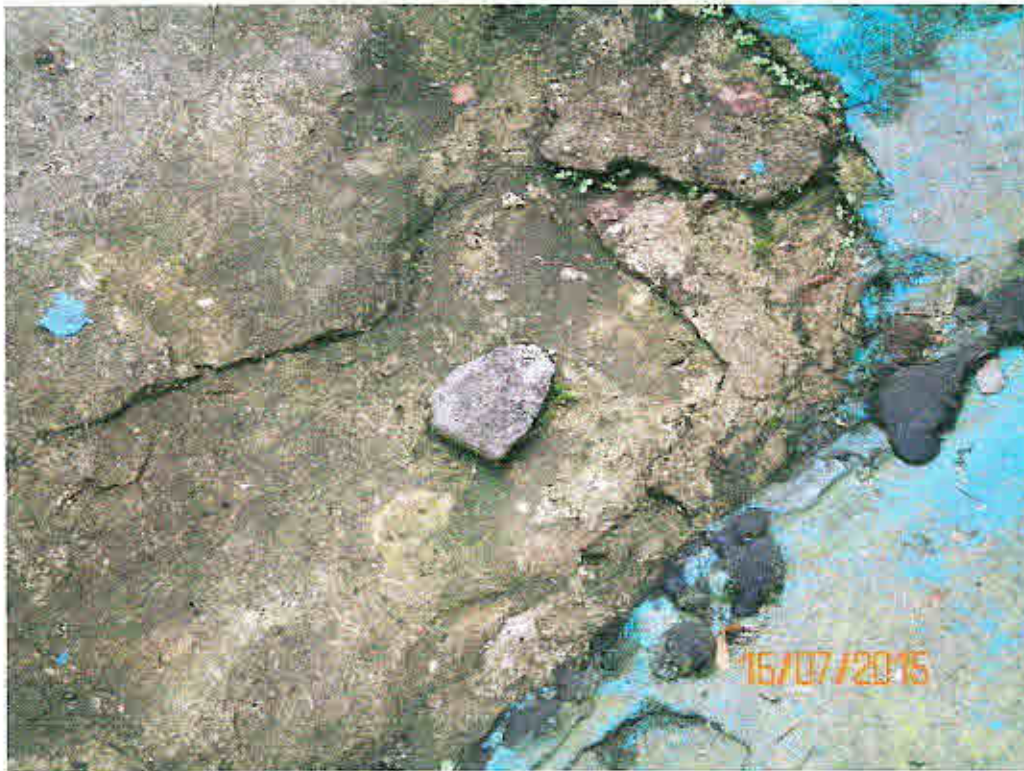
Bild 45: Bodenplatte, Abplatzungen, Risse
