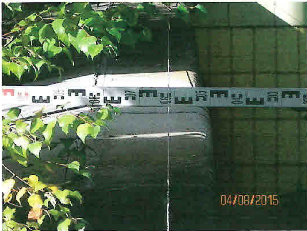
Bild 39 Beckenwand Turmseite, Verformung/Durchbiegung
