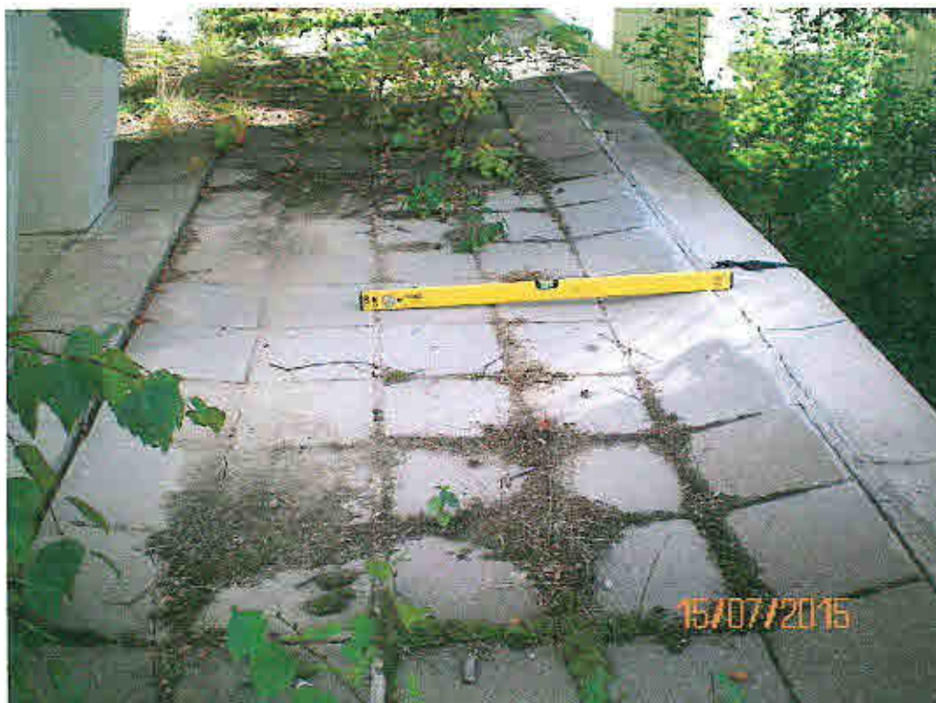
Bild 42 Fläche zwischen Turm und Beckenwand, Absenkung
