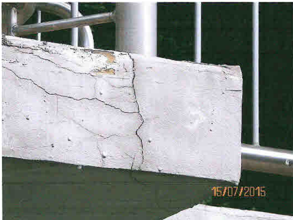
Bild 28: Podestplattenecke, Eckabriss am Geländerstiel,
