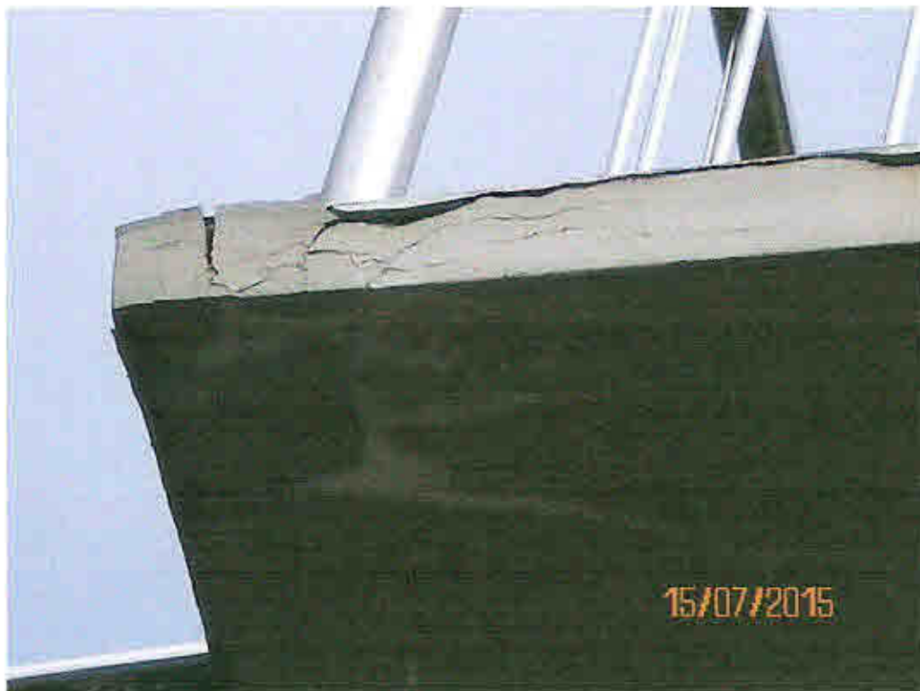
Bild 30: Eckabriss, Horizontalsisse im Podestplattenrand
