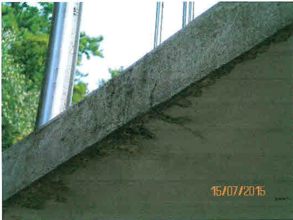
Bild 23: Riss in Podestplatte, stirnseitig unterseitig, UPR
