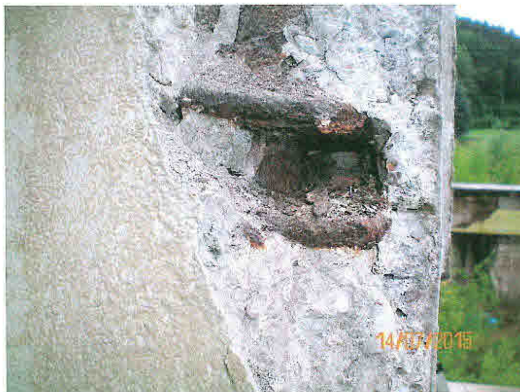
Bild 8: Detail Betonfehlstelle 1, Ecke OSR/ASR
