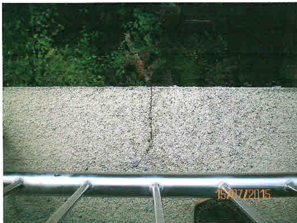
Bild 24: Riss in Podestplatte, oberseitig und stirnseitig,
