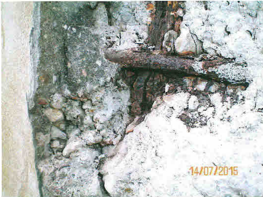
Bild 15: Detail Betongefüge 1, OSL/ISL
