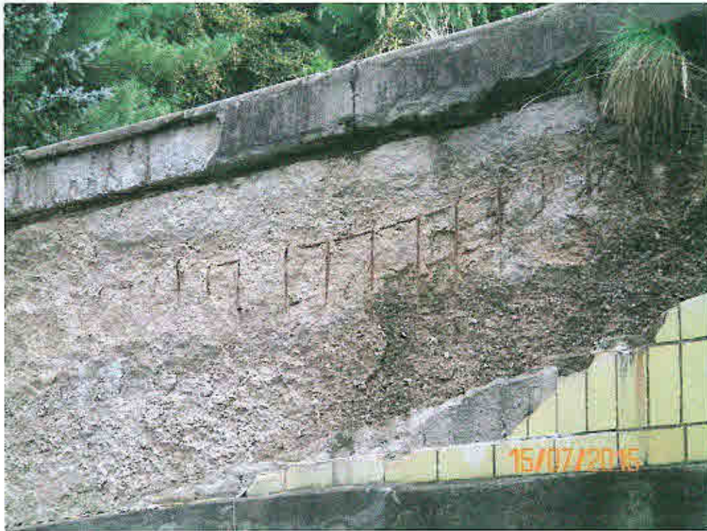
Bild 35: Defekter Wandaufbau, Fliese-Mörtelschicht-Betondeckung-Bewehrungskorrosion
