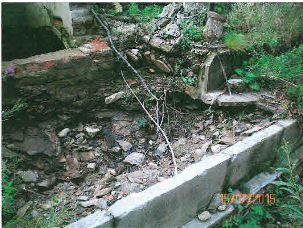
Bild 56: defekter Querschnitt Traversenaufbau, neben Rohrschacht
