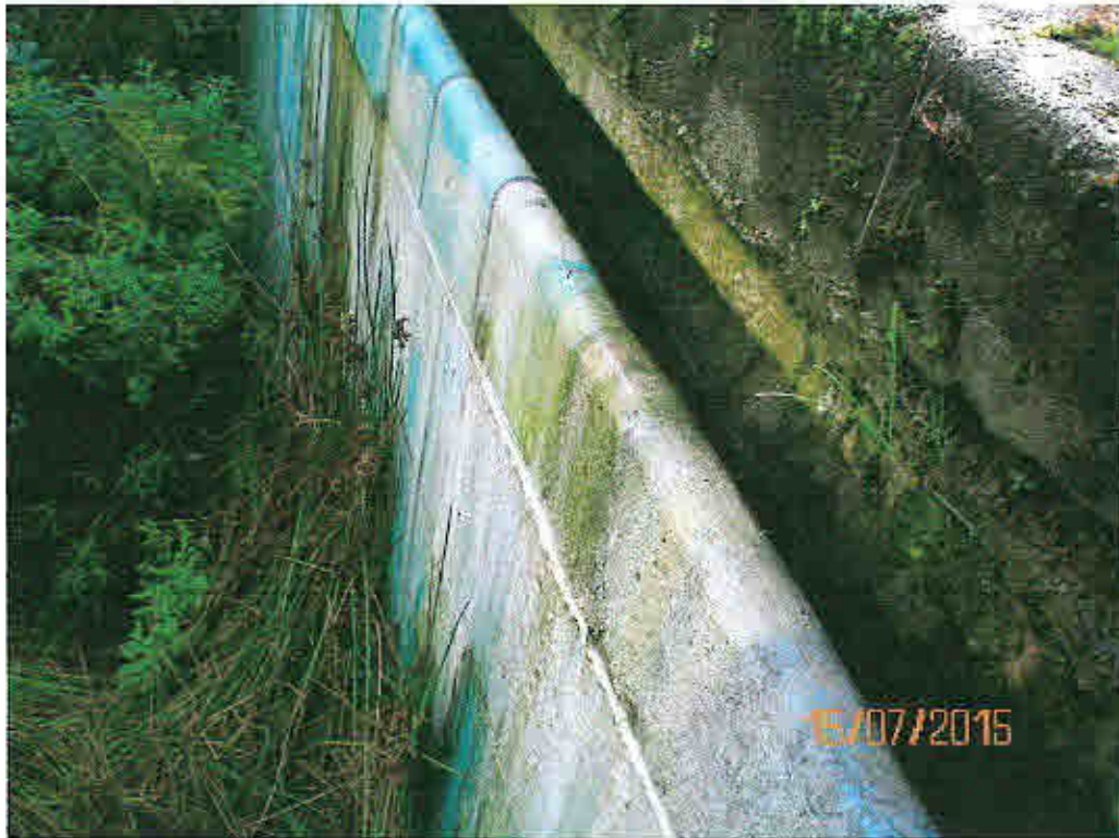
Bild 40: Defekter Mauerkopf, Calciumcarbonatausspülungen
