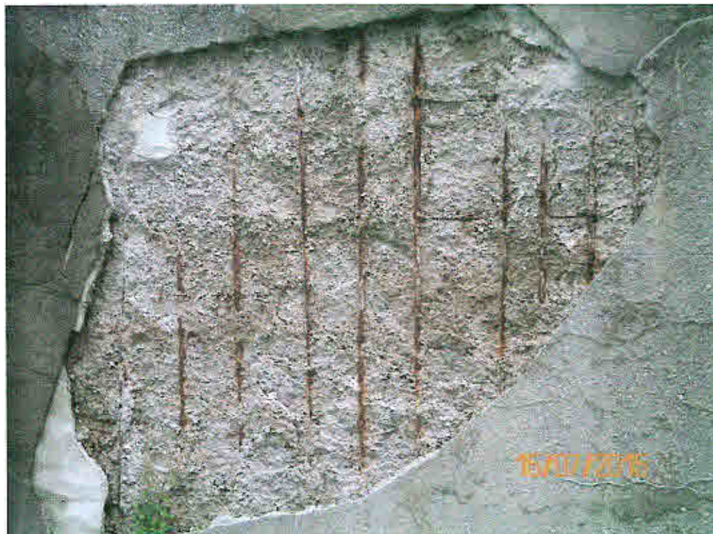
Bild 34: Abgeplatzte Betondeckung, freiliegende Bewehrung
