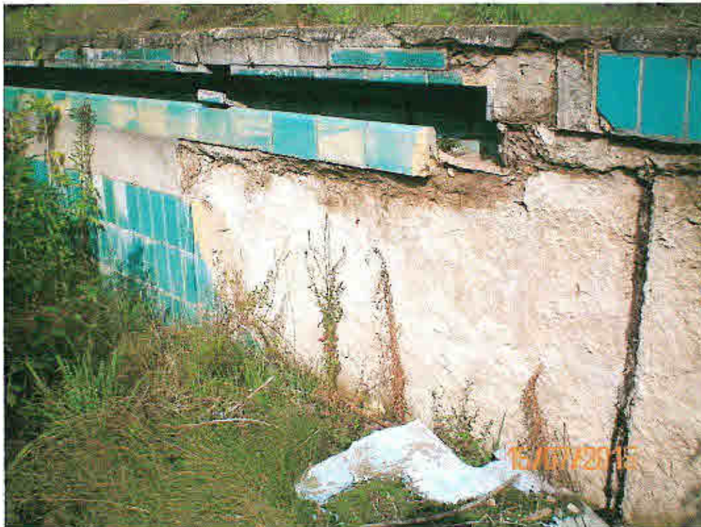
Bild 47: Beckenrand, Schäden an Fliesen, Beton, Mauerkopf, Fugen
