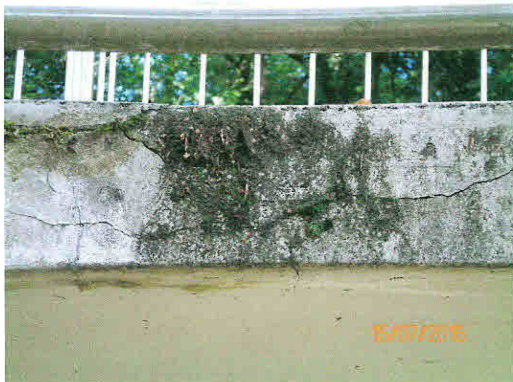
Bild 26: Haufresse in Podestplatte, stirnseitig, unterseitig, oberseitig
