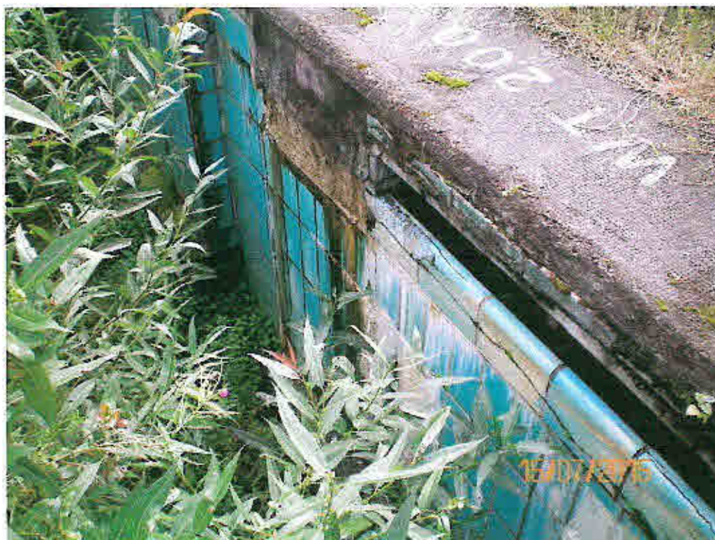
Bild 48: Beton- u. Fliesenschaden
