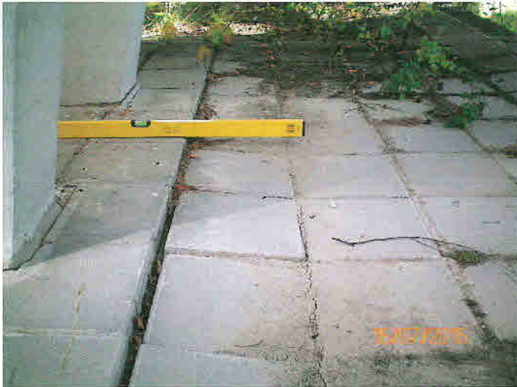
Bild 41 Fläche zwischen Turm und Beckenwand, Absenkung
