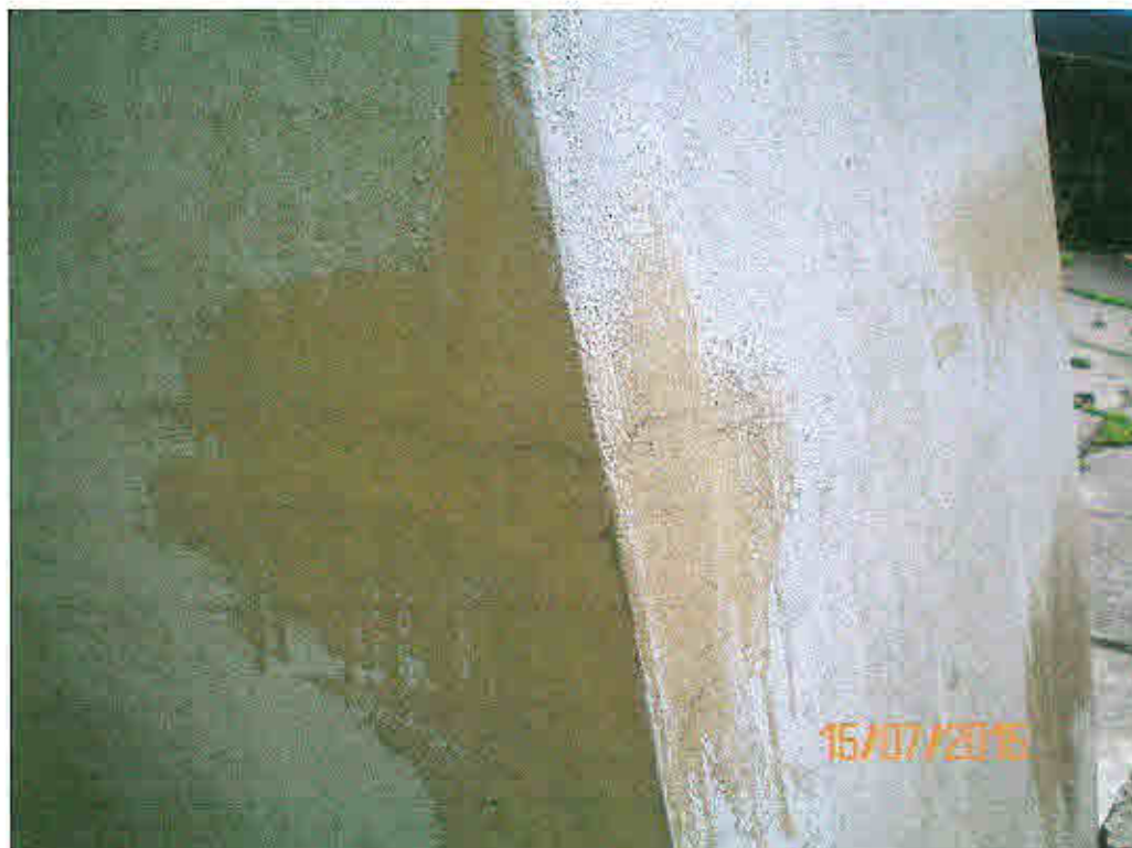
Bild 32: Stiel rechter Turm, Detail Horizontalriss über Eck
