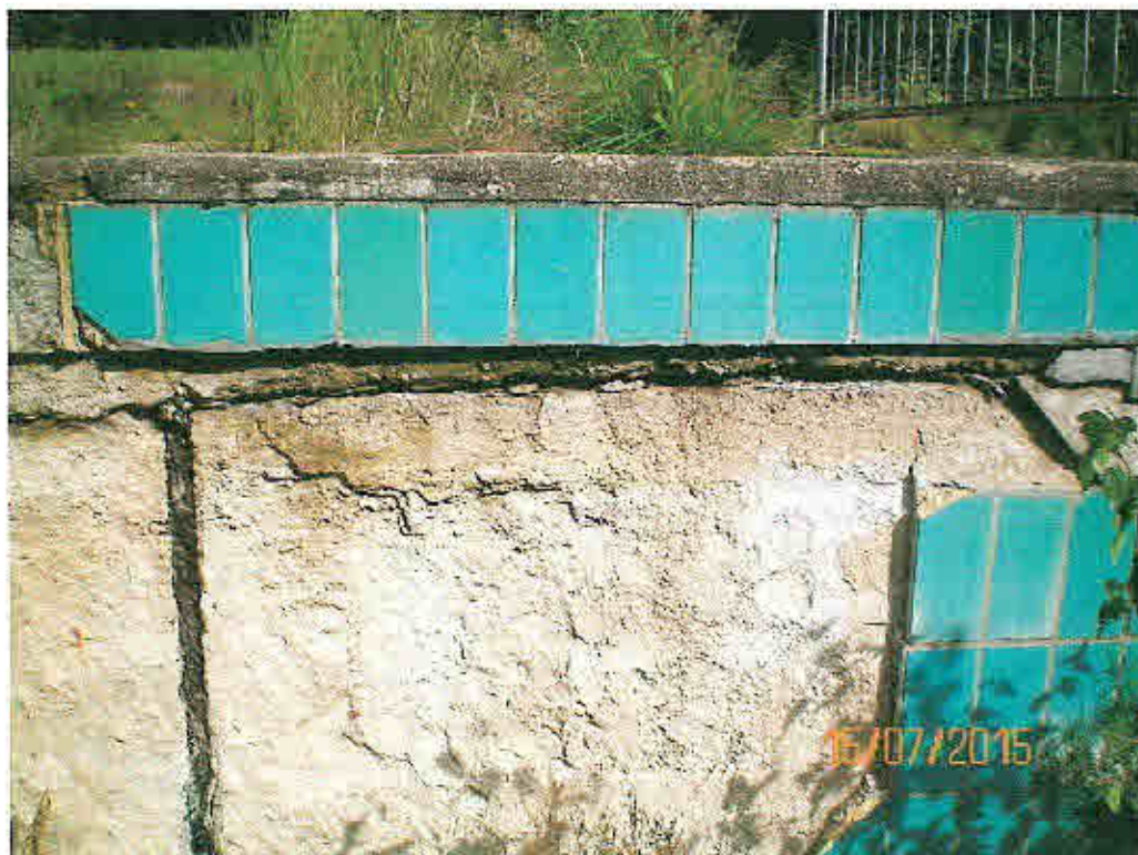
Bild 50: Abgefallene Fliese, Betonabplatzungen
