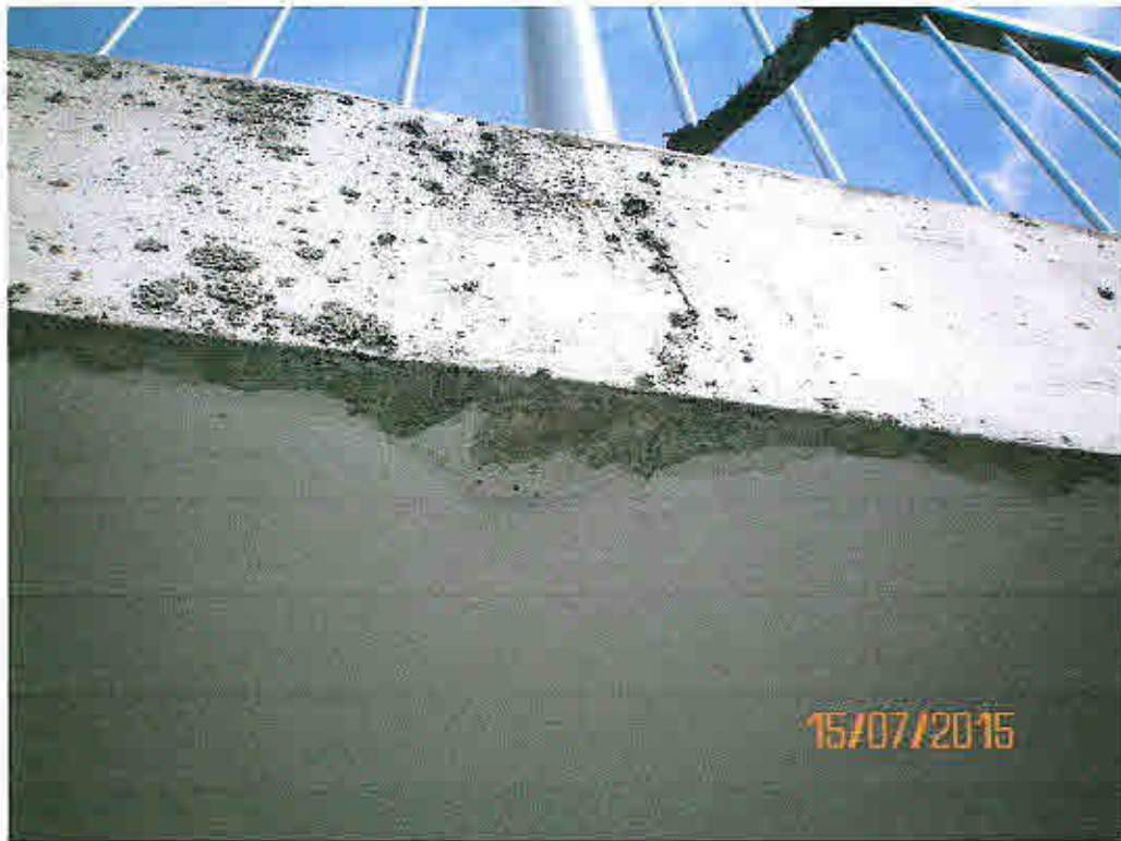
Bild 25: Vertikalriss am Podestplattenrand
