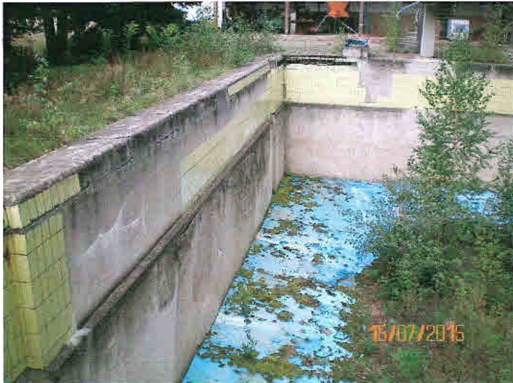
Bild 33: Fliesenfehlstellen, Risse im Ersatzputz, Ausblühungen
