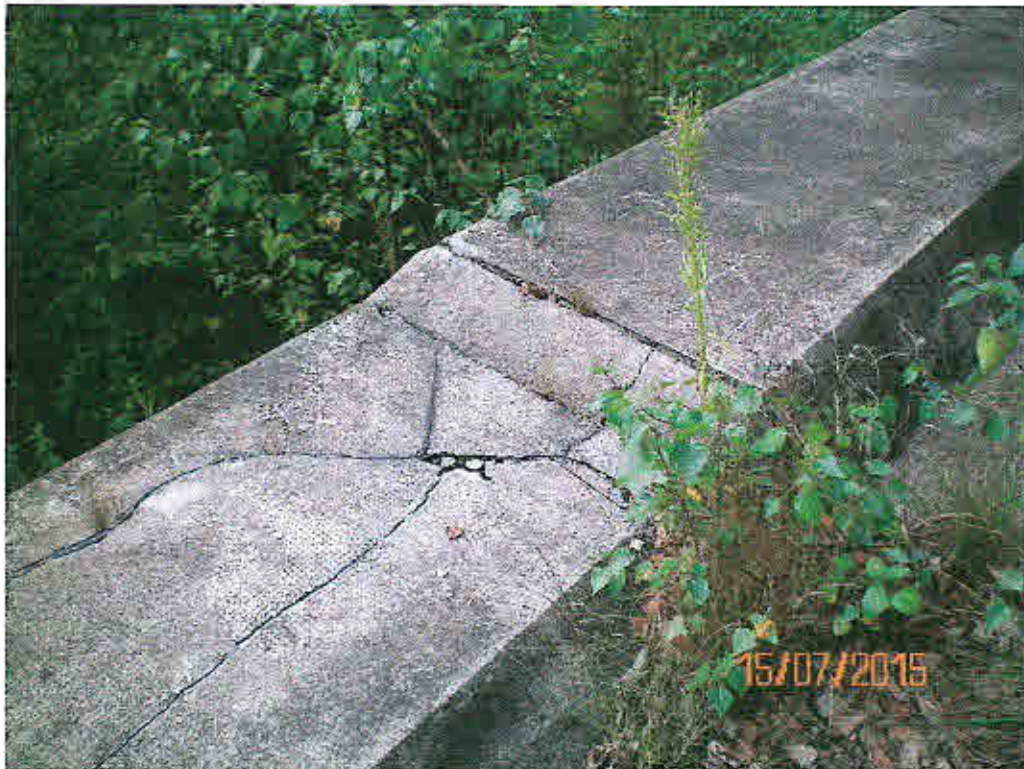
Bild 51: Beckenkopf, Fußwaschrinne, Bruch neben der Fuge, mit Setzungsdifferenz
