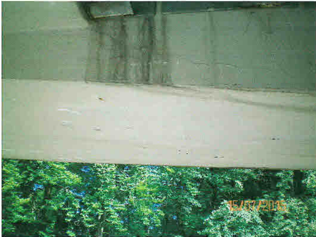
Bild 19: Rissgruppe, ungleichmäßig, Unterseite Podest UPL
