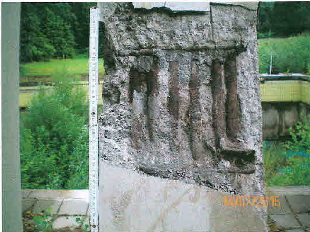
Bild 3: Oberseite gesamte Abplattung, OSR
